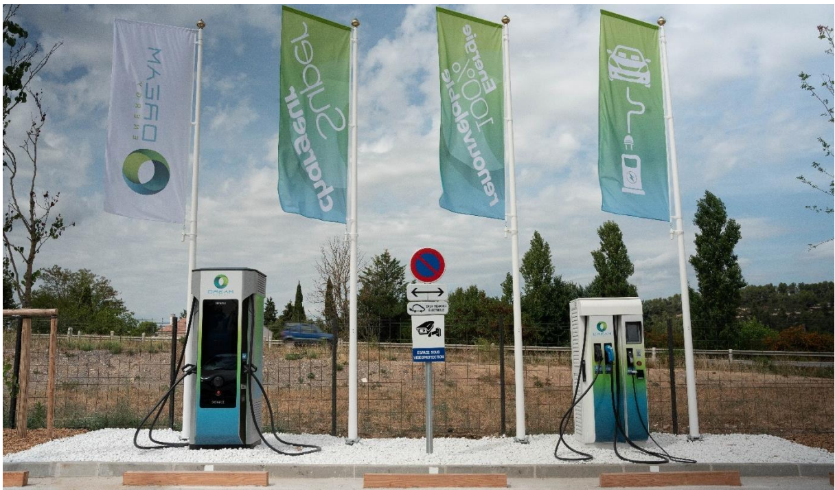
4 ème Station de recharge DREAM ENERGY MOBILITY à Fuveau (13)
