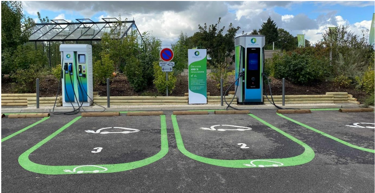
3 ème Station de recharge DREAM ENERGY MOBILITY à Lesquin (59)
