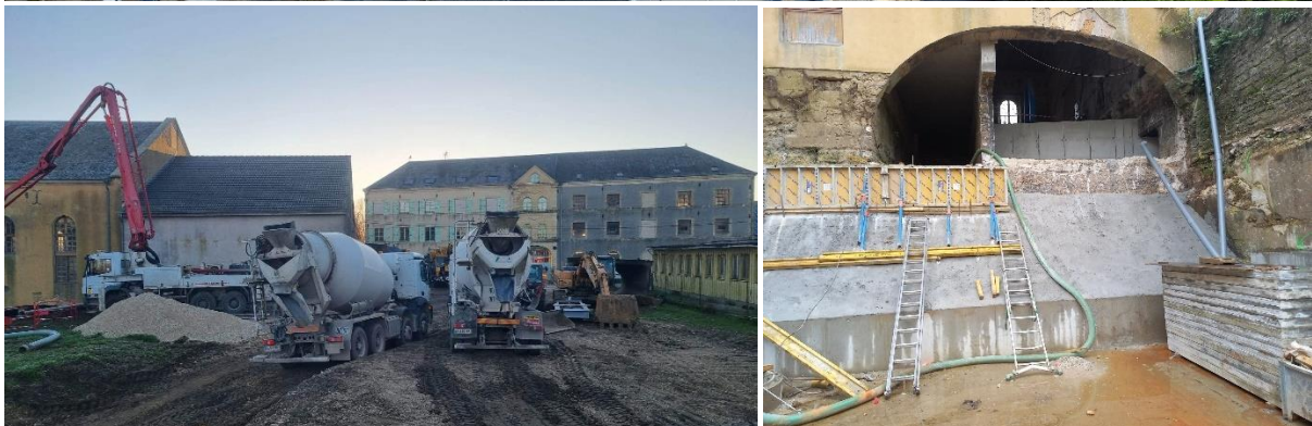
Reconstruction de la chambre d'eau et canaux d'arrivée et sorti d'eau (génie civile)
