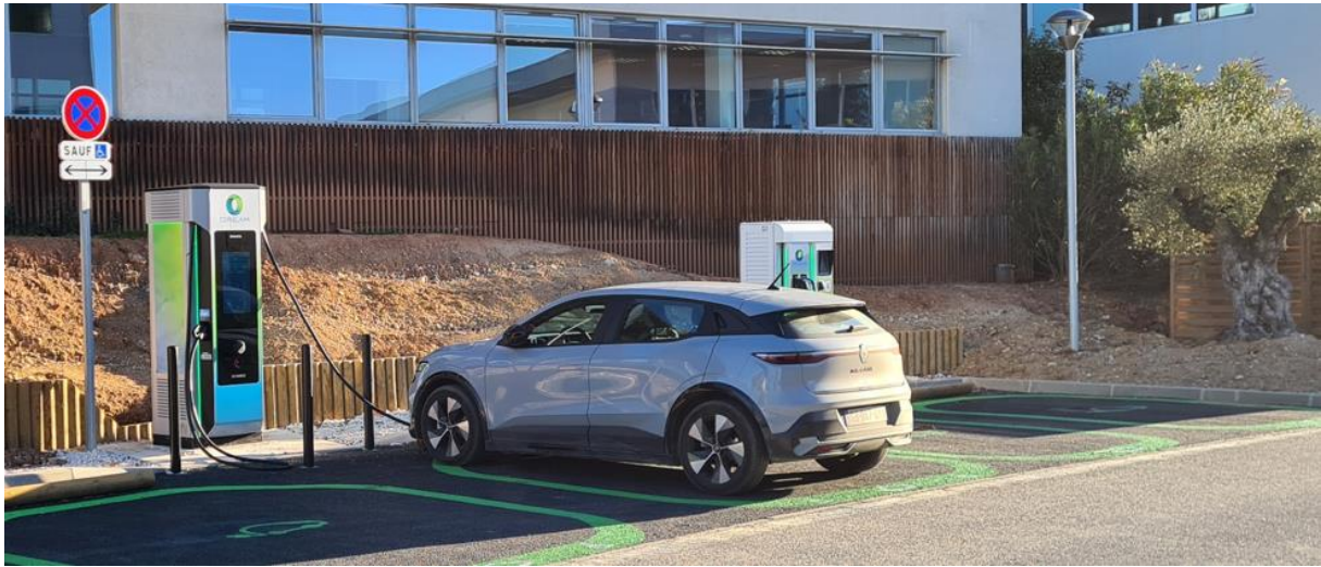
5 ème Station de recharge DREAM ENERGY MOBILITY à Meyreuil (13)
